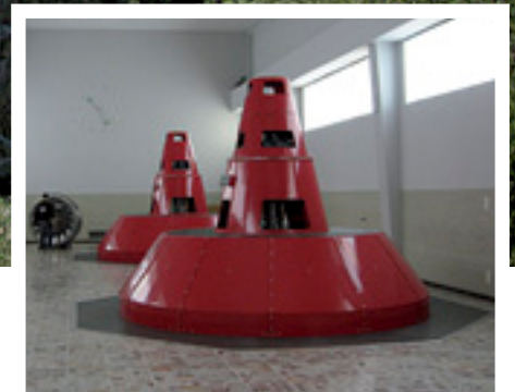
▲ Maschinenhaus von WKW Gordola
