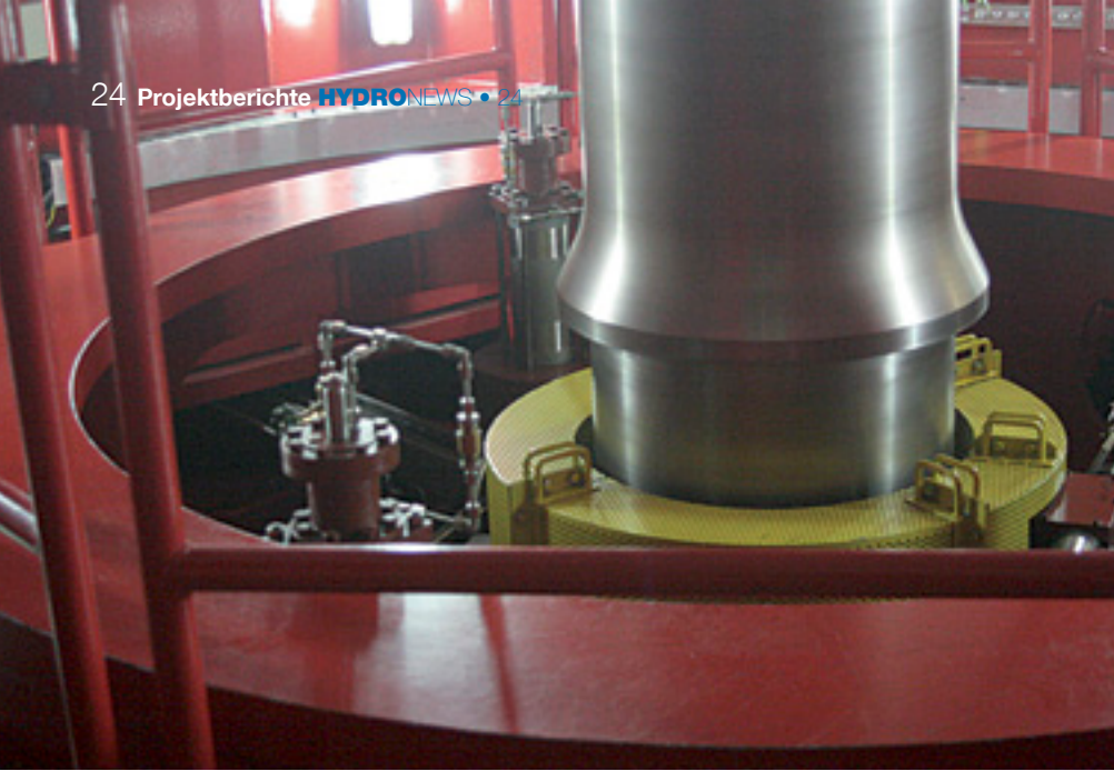
▲ Detailansicht der neuen Turbine von Maschinensatz 3
