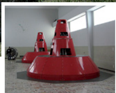
▲ Sala de Máquinas en CH Gordola
