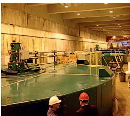
▣ Salle des machines
