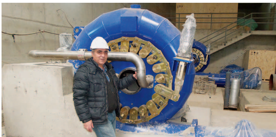
Un représentant du client devant la turbine Francis COMPACT d'ANDRITZ HYDRO
