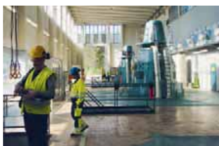
▣ HPP Bjurfors Övre machine hall
