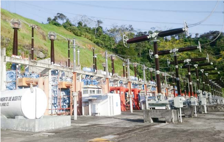
Haupttransformatoren des WKW Malpaso
