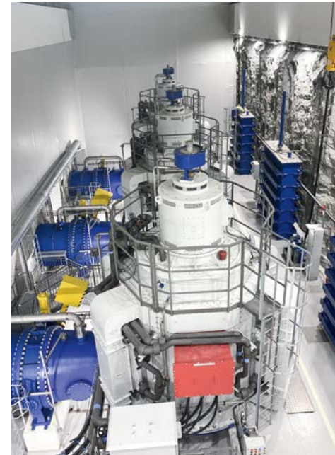
Das Maschinenhaus von Tolga. Das neue Laufkraftwerk ist mit drei identischen 15-MW-Compact-Francisturbinen ausgestattet.
