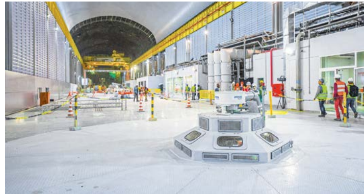
Das Hauptmaschinenhaus ist mehr als 270 m lang und nimmt sechs Maschinensätze mit einer Nennleistung von jeweils 335 MW auf.
